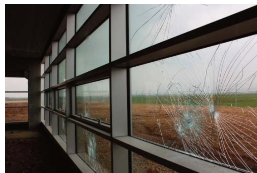
Le vetrate rotte nell'ultimo raid dello scorso dicembre
